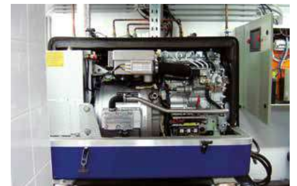
Ez a háromfázisú Panda egy pincében van telepítve. A fő biztosítók, a panel és a radiátor vezérlés az elektromos szekrényben található.
